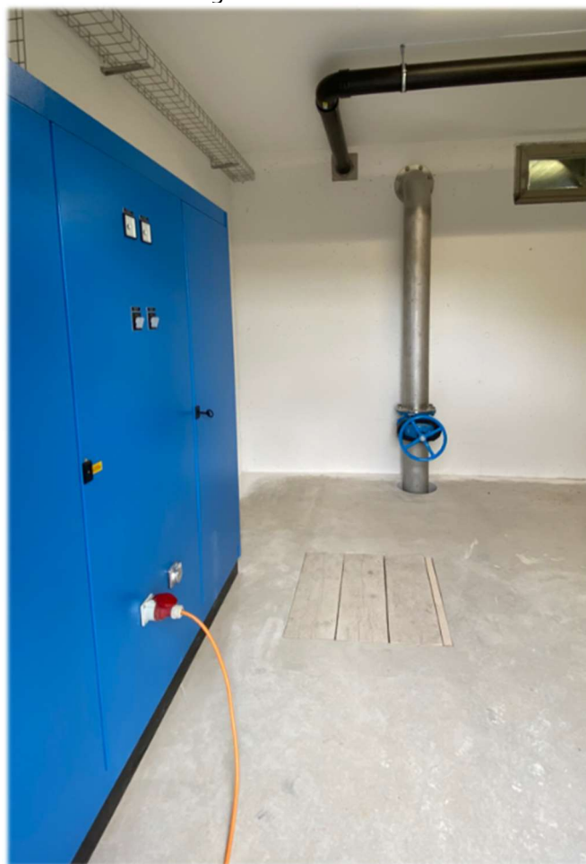
Steuerung und Zulauf Kammer 1
